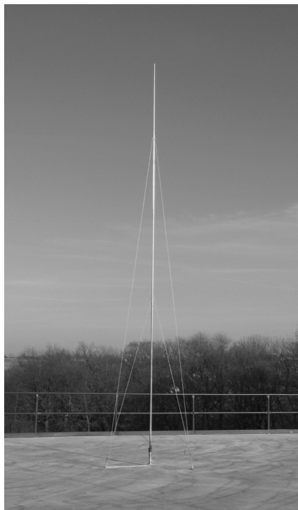
Rys. 10.9. Odgromnik na zbiorniku fermentatora, („Agrobiogazownia” w Kostkowicach), (fot. J. Karłowski).
