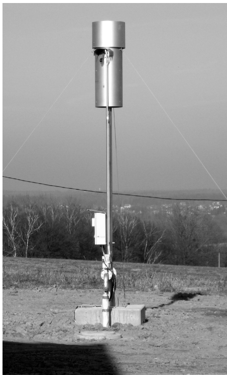
Rys. 10.8. Pochodnia do dopalania resztek biogazu („Agrobiogazownia” w Kostkowicach), (fot. J. Karłowski).
